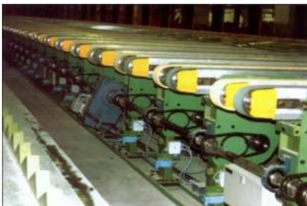
Querförderer für Aluminiumprofile „Norsk Hydro“
